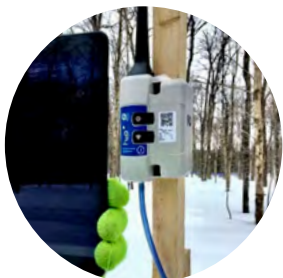
Installation d'un système de surveillance
